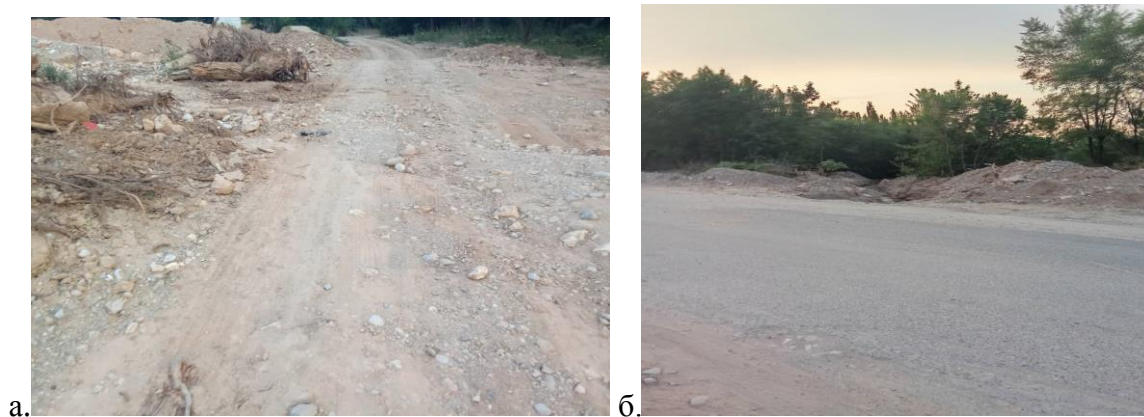
Рис. 2. Смытая часть территории леса, а; смытая часть автодороги, б.
